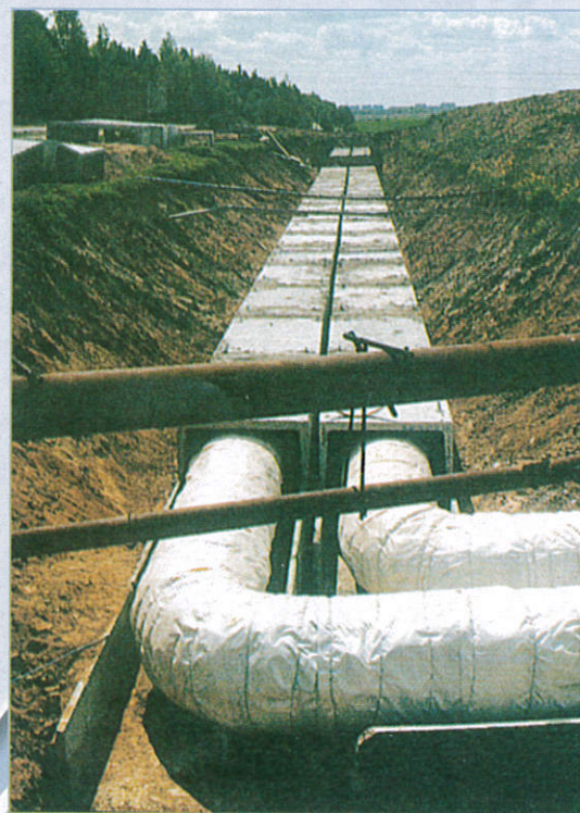
Тепломагистраль от микрорайона «Лошица».
